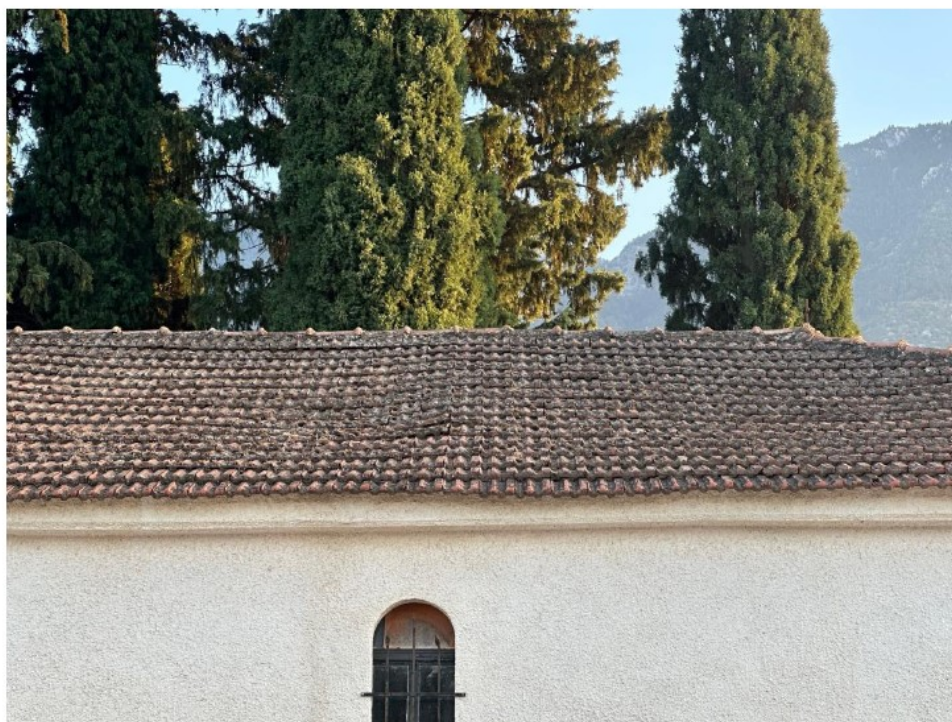
Φώτο 4: Βόρεια όψη της στέγης με εμφανείς καυτηρήσεις – φθορές της στέγης
