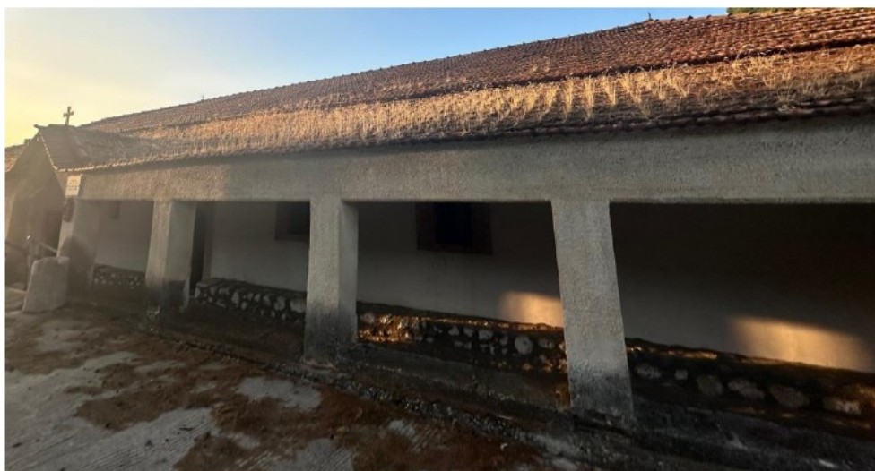
Φώτο 3: Στέγη ανοιχτού υπόστυλου χώρου με εμφανή την κακή κατάσταση των κεραμιδιών
